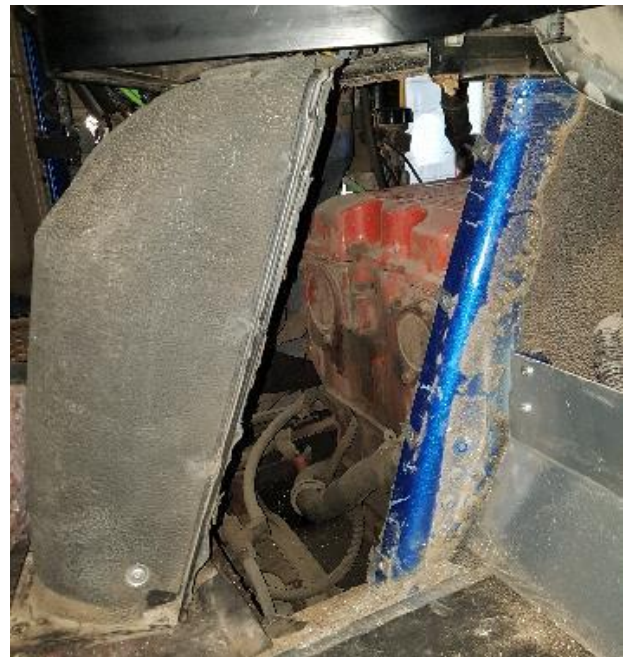
Imagen 3. Cubierta de protección del motor hacia la cabina (Giba)
